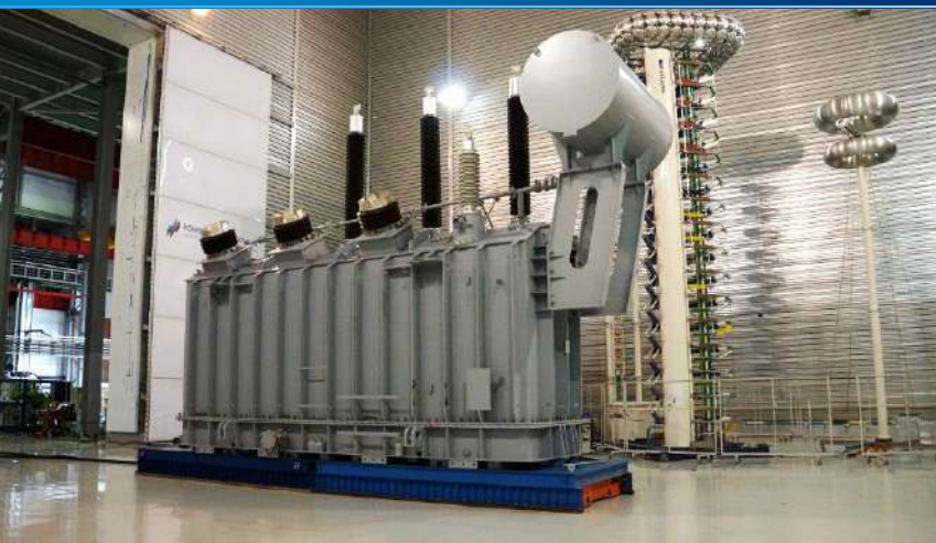
Богучанская ГЭС ТЦ-400000/220-УХЛ1
