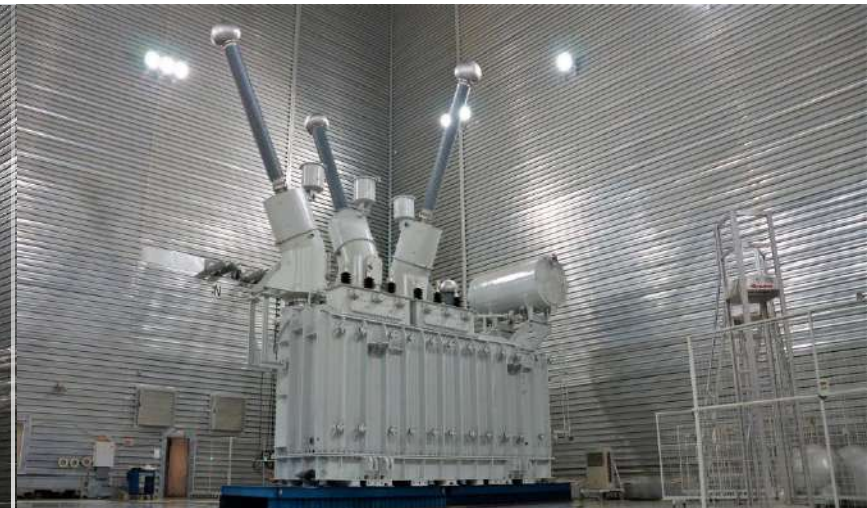
АЭС Аккую ТРДНС-80000/400-Т1
