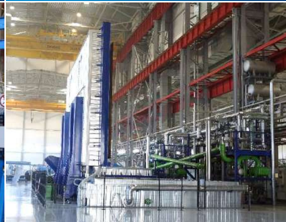
Печи термовакuumной сушки (Hedrich, Германия)
