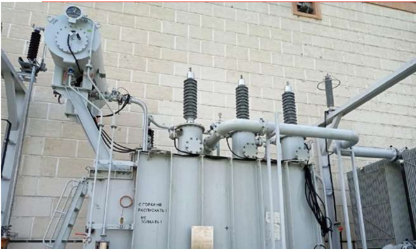
Фархадская ГЭС ТДЦ-42000/110-У1
