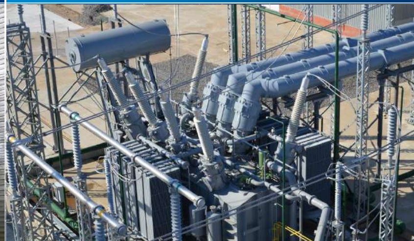
Волжская ГЭС ТДЦНФ-195260/220-У1
