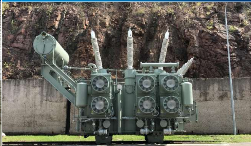
Красноярская ГЭС АТДЦН-63000/220/110-УХЛ1
