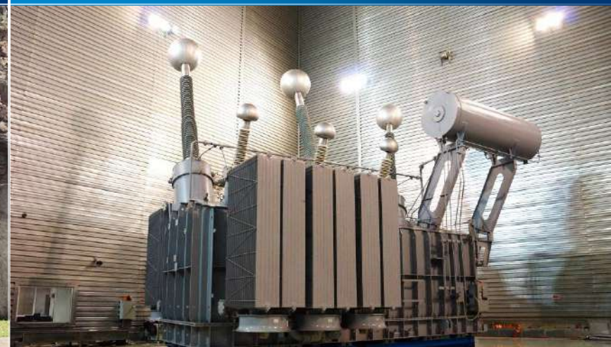
ПС Сибур АТДЦН-250000/500/110-ХЛ1
