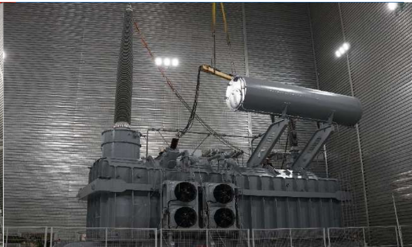
Ленинградская АЭС АОДЦН-417000/750/330-У1
