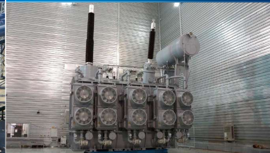
Воткинская ГЭС АОРДЦТ-167000/500/220-У1
